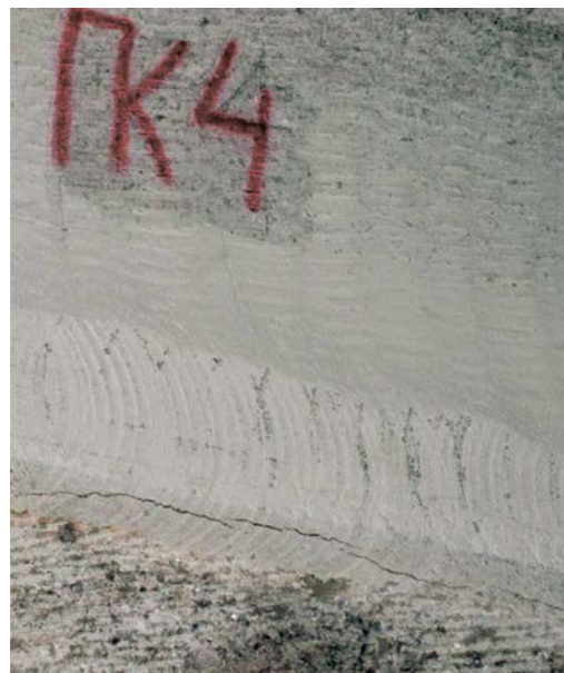
Рис. 4 – Техногенная трещина в присводовой части горной выработки Тыретского солерудника. Фото автора, 2017.
